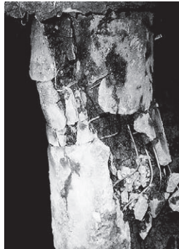
杭頭を剛接した杭の被害例
