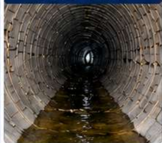
下水道の老朽化
