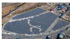
太陽光発電所
