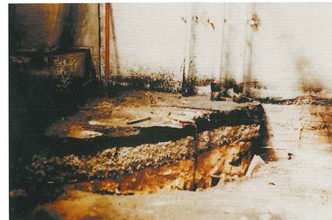
土間コンクリート床の破損
