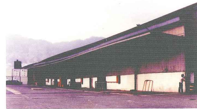
不同沈下建物例
