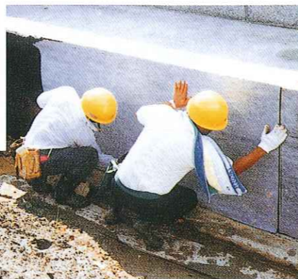
さいたま市大宮地区 ソニックシティビル地下外壁SLシート貼付
