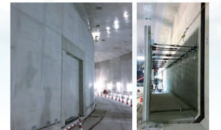
■ 避難通路・換気ダクト
