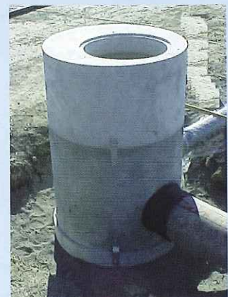
対応型マンホール全景
