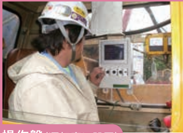
操作盤 (運転席に設置)
