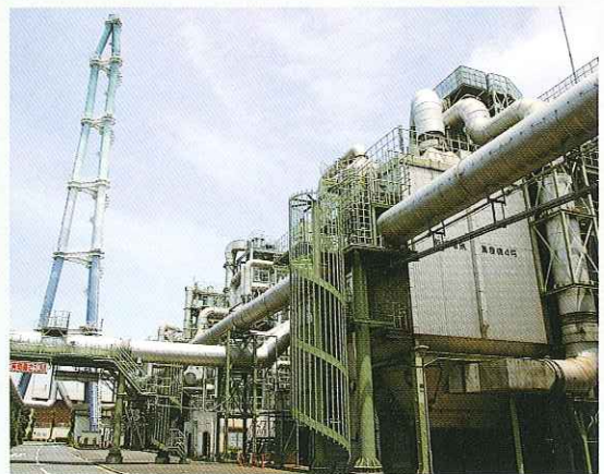
東京都下水道局 葛西水再生センター 汚泥焼却施設
