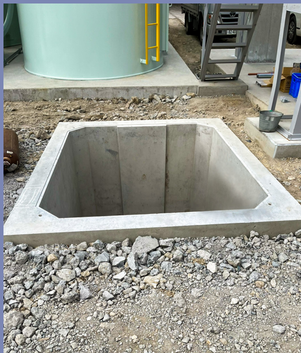
角型マンホール
