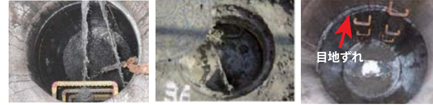
人孔側塊目地ずれによる土砂流入と土砂堆積の様子
