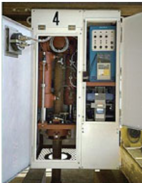
ジャッキ制御室
