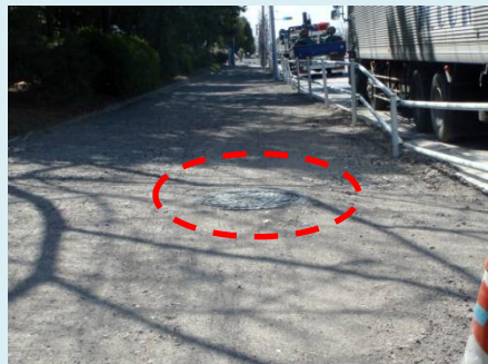
消散弁が作動し浮上しなかった人孔
