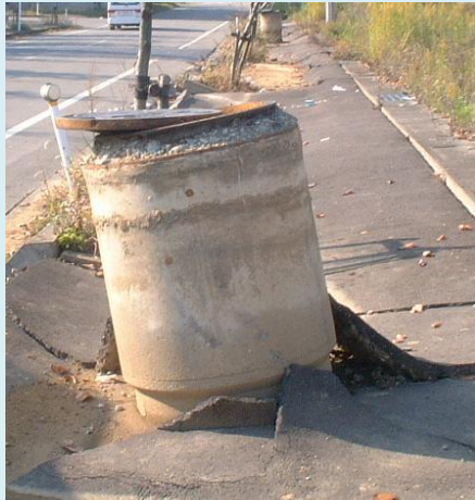
中越地震における人孔の浮上例
