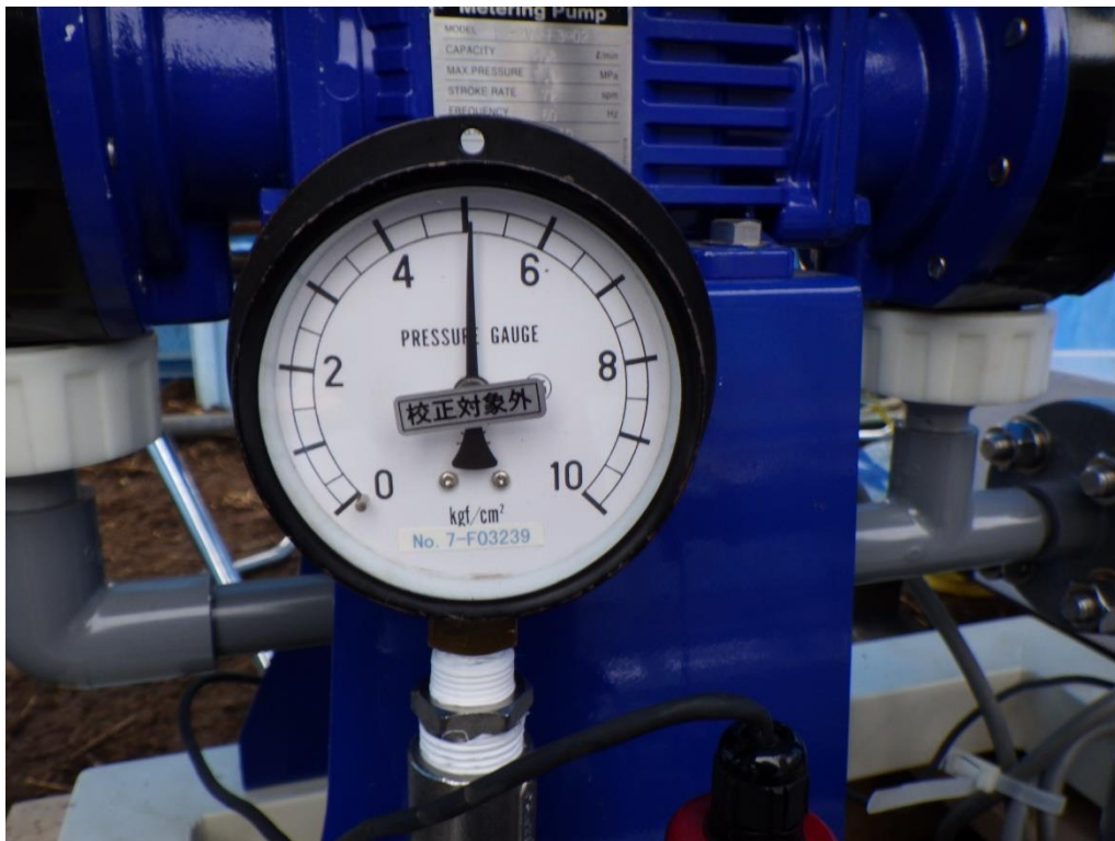
(参)写真-60 圧力ゲージ
