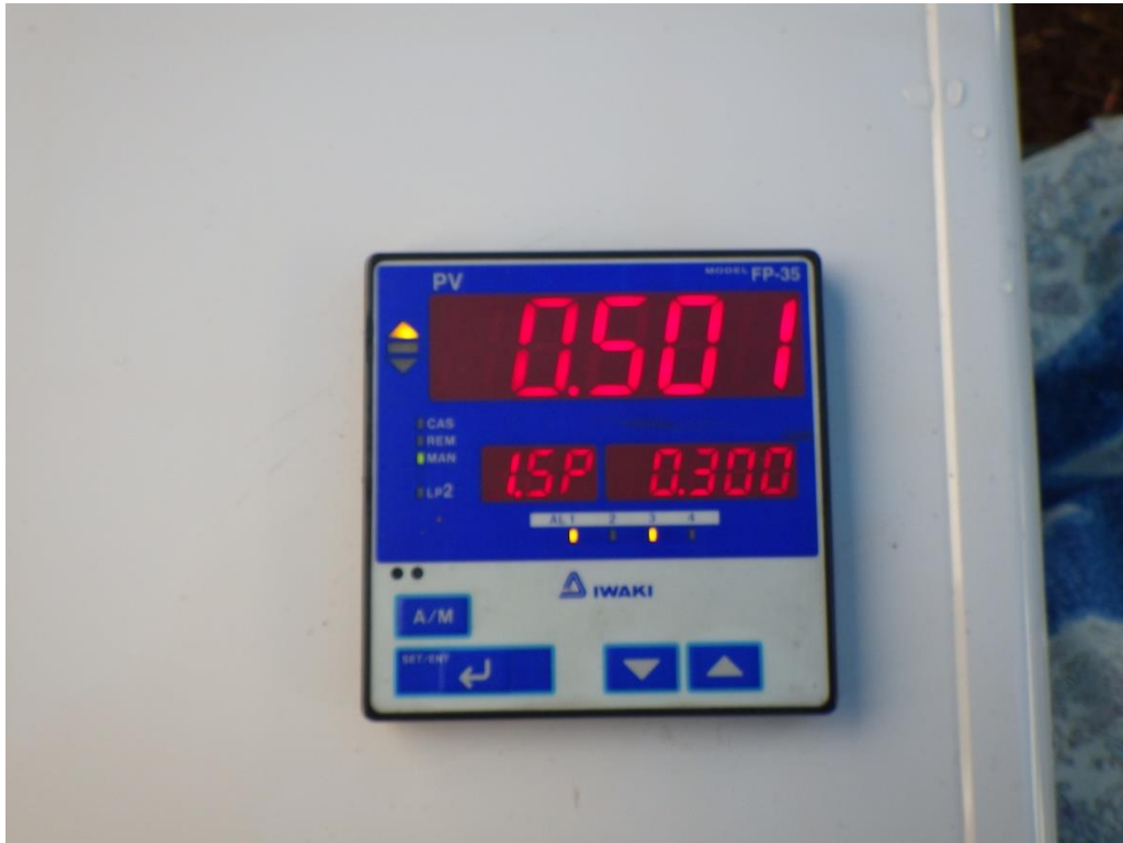
(参)写真-59 水圧ポンプゲージ
