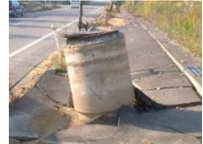
地震でマンホールが隆起した写真
