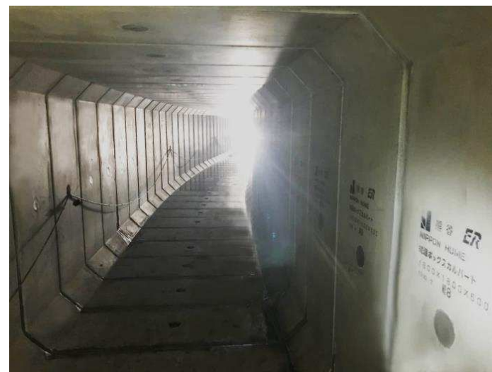
雨水貯留管：合成ボックスカルバート（東京都内）
