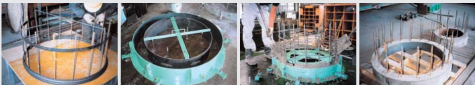
(1)配筋状況 (2)鋼板リングを型枠にセット (3)コンクリート打設状況 (4)型枠脱型後
