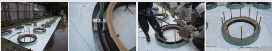
(1)製作ヤードの状況 (2)定着筋をセット (3)コンクリート打設状況 (4)コンクリート打設後
