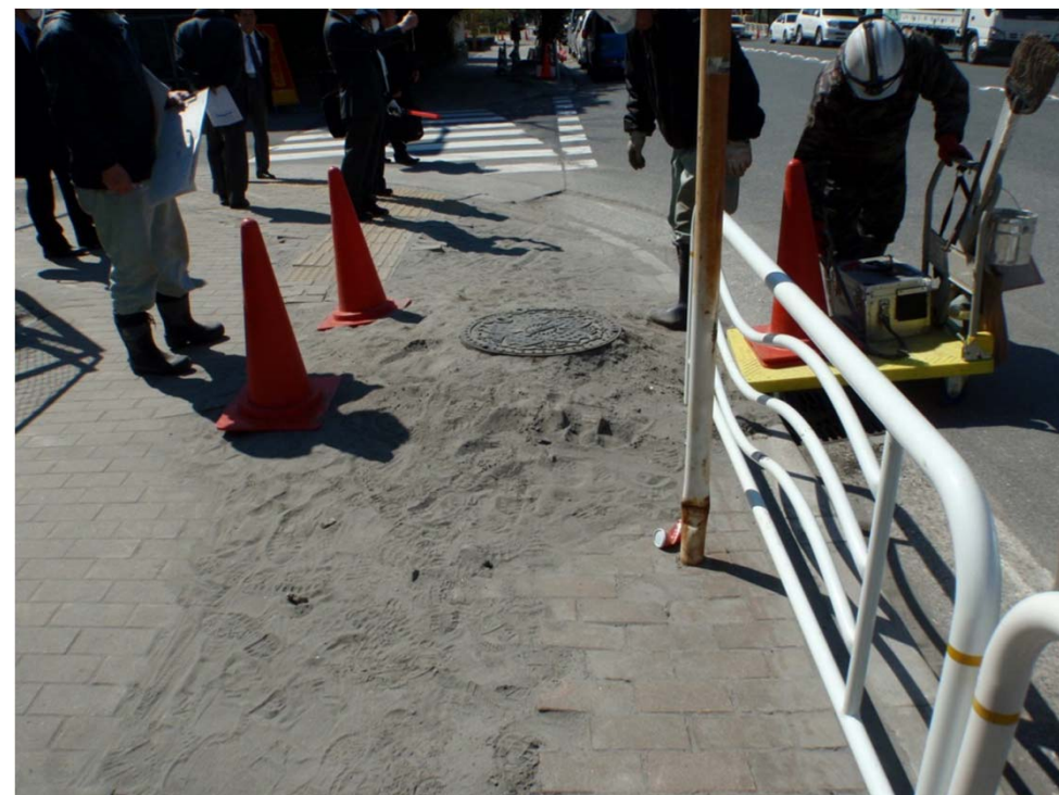
マンホール隆起抑制状況 (東日本大震災発生時 東京都江東区)
