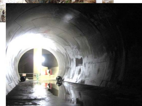
貯留管 (セグメント)
